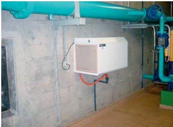
2 Entfeuchtungsgerät mit Filter, wo sich die radioaktiven Zerfallsprodukte von Radon ansammeln können.
